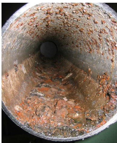
Figuur 1. Inwendig gecorrodeerde sprinklerleiding. (bron: KWA Bedrijfsadviseurs BV)
