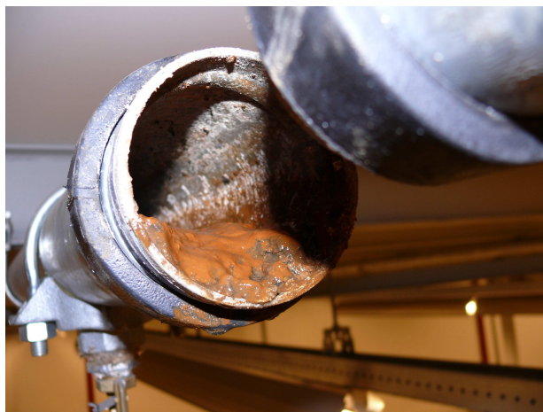
Figuur 5. - Drab in een sprinklerleiding (bron: KWA Bedrijfsadviseurs BV)
