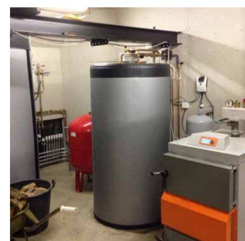
Ketel (rechts) met buffersysteem
